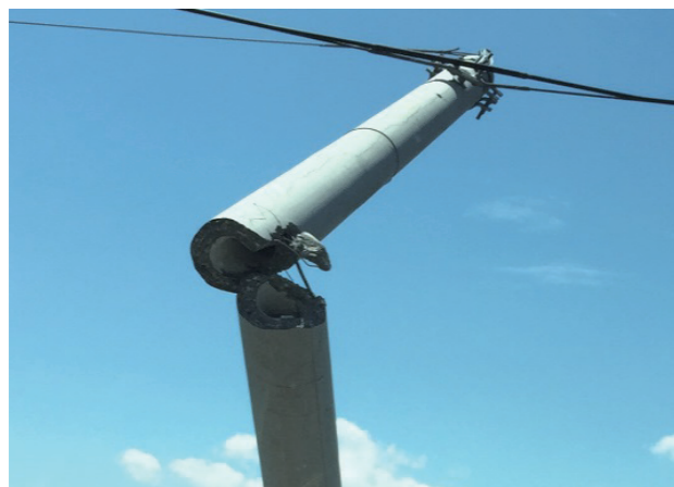
※実際に倒壊したコンクリート柱
