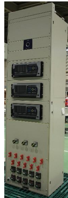
【写真】 水力発電所へ納入した IED 適用保護継電器盤
