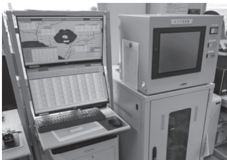
【ダム情報監視装置】
